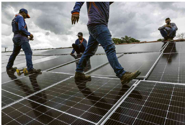
Operários instalam painéis solares fotovoltaicos no telhado de um motel na periferia de Boa Vista (Roraima). Foto: Leticia Almeida - 28 Jul 2022 / Fofopress
